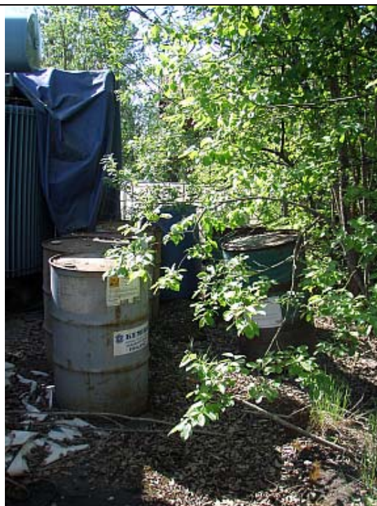
Bilde 14. Gamle oljefat bak transformatorene og ved prøvelokalitet 10.
