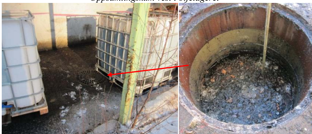
Oppsamlingskum øst i oljelageret
