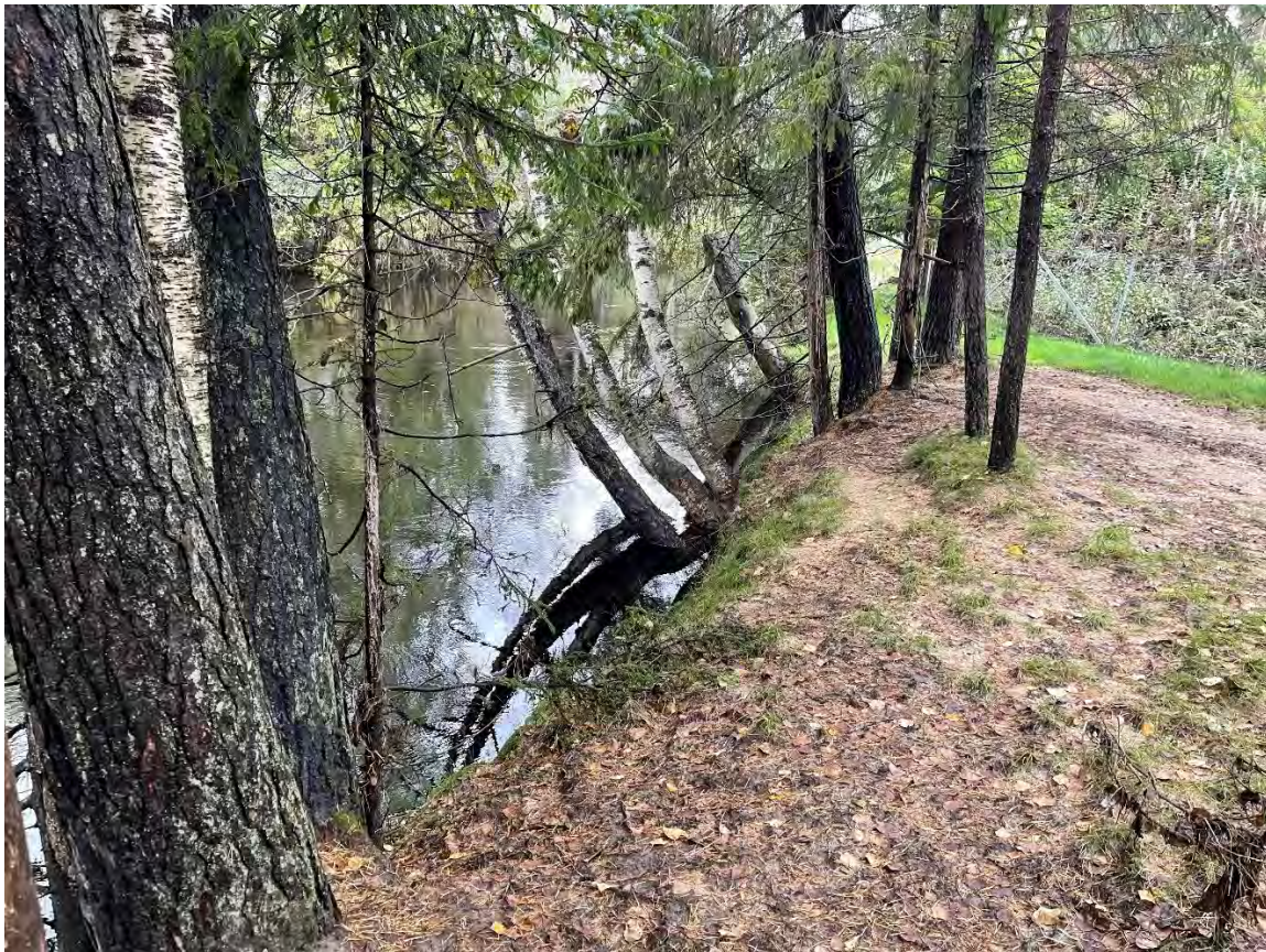
Figur 29: Tegn på undergraving i elvebredden, skråstilte trær på østsiden av Songa opp mot jernbanebrua. Sjekk med målestav viser at elvebunn ligger dypt like inn til elvebredden, rundt 1,5 meter.
