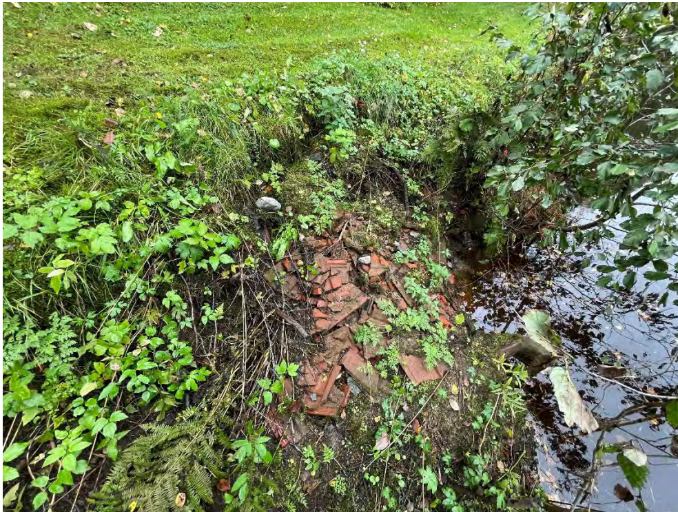
Figur 19: Mulig utglidning i befaringspunkt 1 ved Songa, rett vest for tiltaksområdet. Teglstein og andre antatt utfylte masser. Evt. har massene blitt lagt ut for å fylle igjen etter en utglidning.
